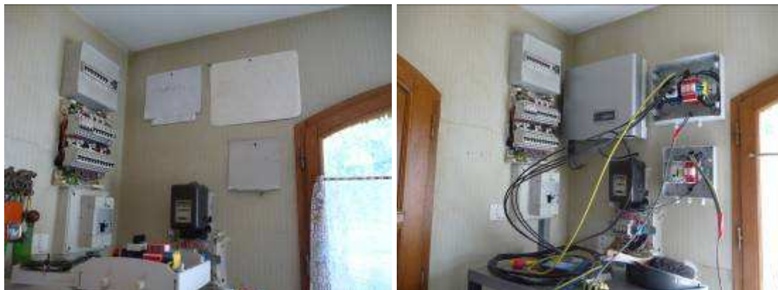
Implantation de l'onduleur et des coffrets de sécurité
